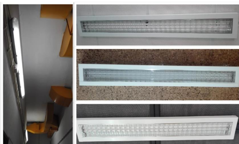
Figura 4 – Situação inicial: Sistemas de iluminação interior
